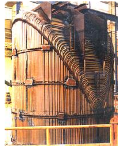
▲ 蒸気発生器の細管
